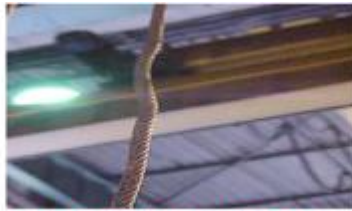
CABO COM DEFORMAÇÃO
