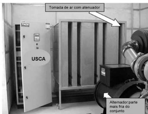
FIGURA 1: Outros detalhes do leiaute da sala do gerador – tomada de ar
