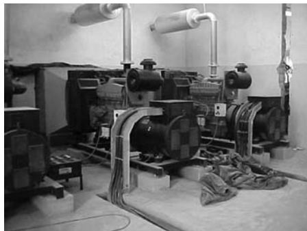
FIGURA 5: Grupo motogerador. Fonte: MTB 48 - Segurança contra incêndio nas edificações e áreas de risco
