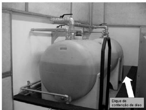
FIGURA 2: Outros detalhes do leiaute da sala do gerador – dique de contenção de óleo / tratamento acústico nas paredes
