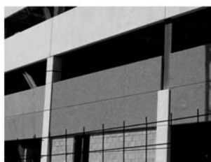
FIGURA 44 - Pilares de aço protegidos com pré-moldados de concreto. A resistência ao fogo para esses componentes particulares é de 60 minutos
