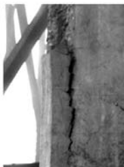
FIGURA 6 - Spalling em pilar de concreto
